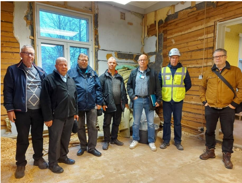
Työmaakatselmus kerran kuussa, vasemmalla seurakunnan edustajat Markku Viljanen, Pertti Laaksonen ja Rauno Saarnio. Keskellä urakoitsijat Olli Mäkelä ja Lasse Kivistö. Työmaanvalvoja Pasi Rantatupa on asianmukaisesti varustautunut. Oikealla arkkitehti Marko Suutarla. Kuvajaana kirkkoherra Annakaisa Rantala
